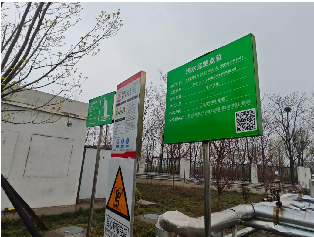
图 8.3-1 废水总排口规范化设置
