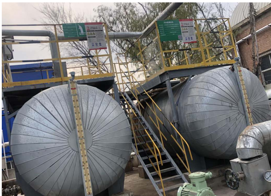
图 9.2-1 废水排污口及监测点位现状照片（草酸银废水预处理设施排污口）
