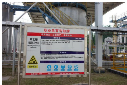
四乙基氢氧化铵储罐
